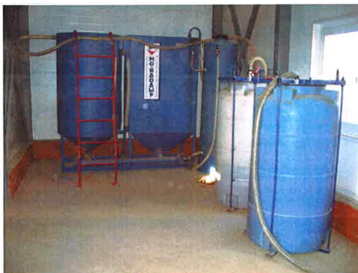
Рисунок 3 – Очистная установка «МОЙДОДЫР-Л(Н)-3».
