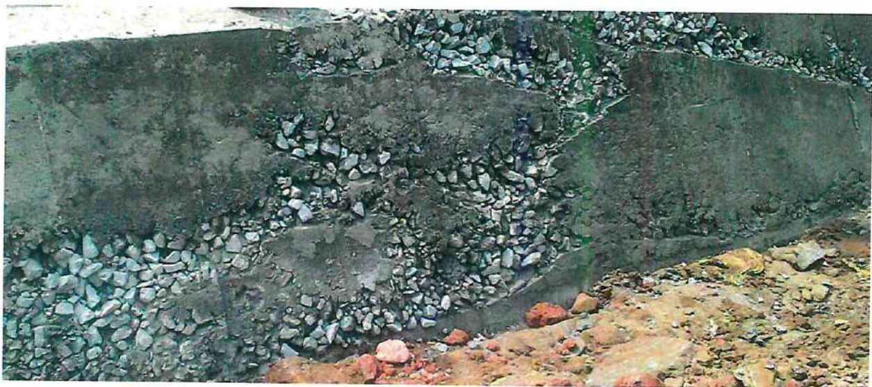
Рисунок 6.3 – Щебенистость на поверхности плиты и полости, незаполненные бетоном
