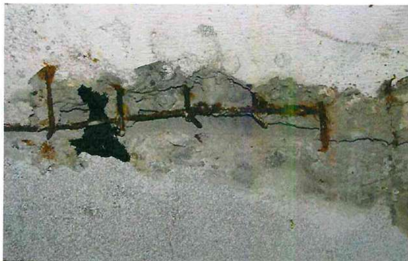
Рисунок 6.1 – Участок колонны с разрушением защитного слоя и оголением арматуры
