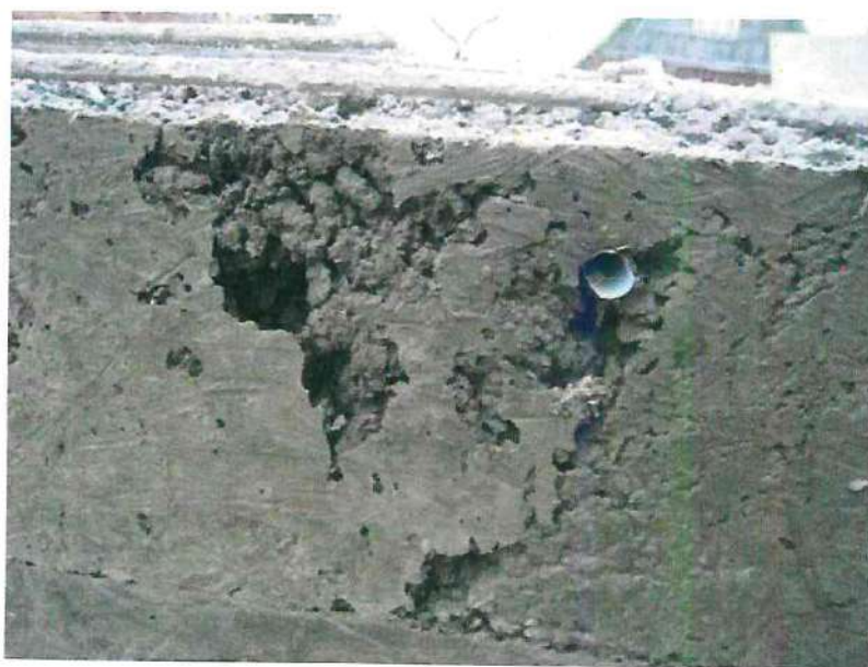
Рисунок 6.4 – Непровибрированные участки стены
