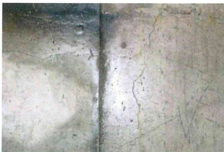
Рисунок 6.5 – Усадочные трещины на поверхности стены
