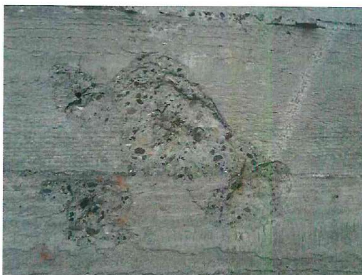
Рисунок 6.2 – Срыв защитного слоя бетона на участке стены, без обнажения арматуры
