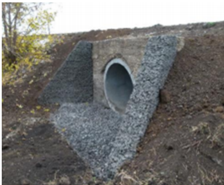
Рис 7. Обетонирование водопропускной трубы под полотном дороги крупнопористым дренирующим бетоном КАПСИМЭТ. Пос. Цельна, Ульяновской области, 2014 год
